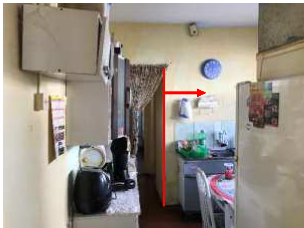
Imagem 114: Parede da cozinha que será revestida com azulejo, com o início da BI a partir do acesso ao banheiro.
