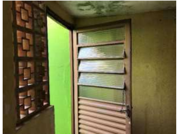
Imagem 127: Vista da Porta P5 no Quarto 3 para substituição.
