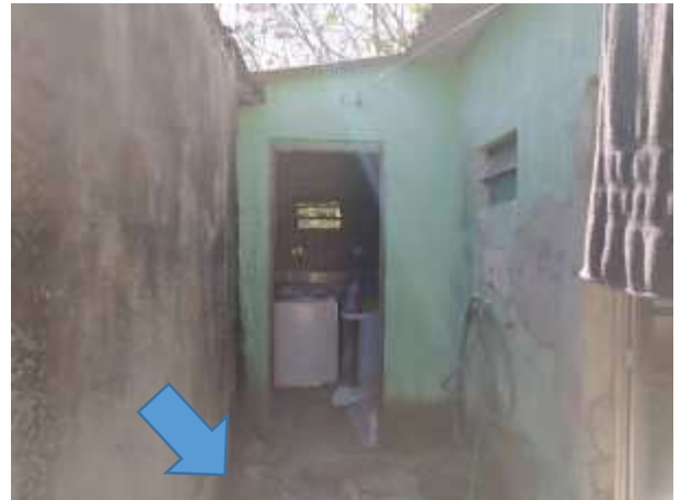
Imagem 51: Piso a ser executado (de concreto armado) entre a porta da cozinha e a lavanderia da última residência do lote.
