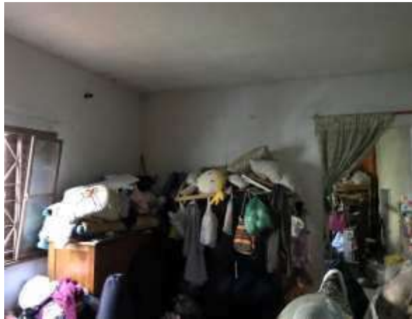
Imagem 128: Visão do Quarto 1 com previsão de reparo na argamassa de revestimento.
