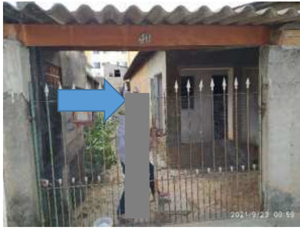
Imagem 260: Fachada lateral (esquerda) da residência, deve receber reboco ao longo de toda a sua área.
