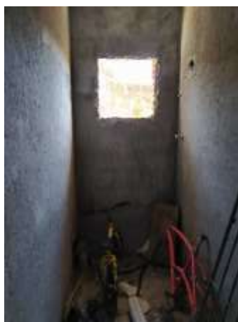
Imagem 38: Paredes do banheiro da 1ª residência que receberão azulejos até a altura de 1,60m (marca Realce, 0,32x0,56m).
