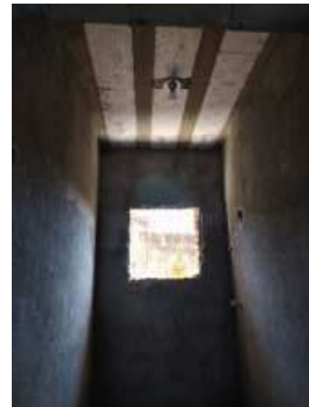
Imagem 25: Vista da janela da 1ª residência que terá seu vão aumentado de 0,60x0,60m para 0,80x 0,80m para a instalação da janela.
