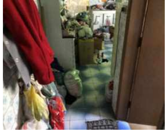
Imagem 139: Indicação do piso da cozinha para substituição.
