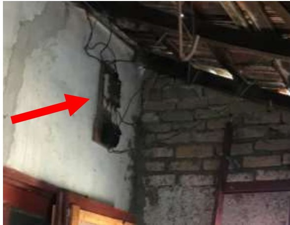
Imagem 209: Visão do quadro de distribuição.
