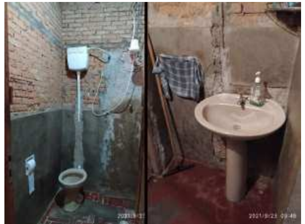
Imagem 252: Parede do banheiro com argamassa (cimento queimado) a ser demolida e que receberá, na sequência, reboco e revestimento cerâmico.
