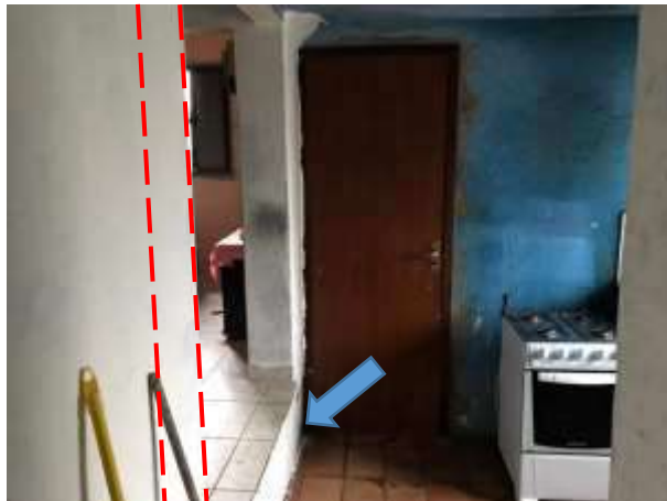
Imagem 278: Degrau a ser demolido e regularizado. Pontilhado indica trecho da parede a ser demolida.
