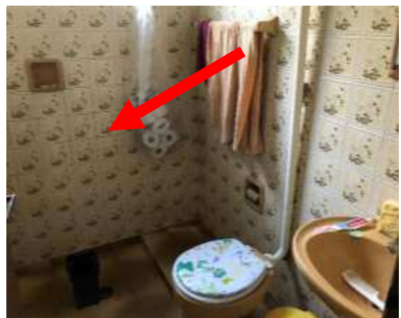
Imagem 145: Local de instalação da barra.
