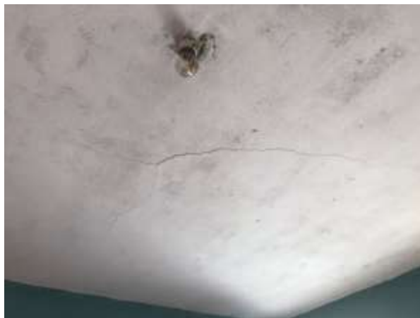
Imagem 178: Laje da sala, que deverá ter todo o seu revestimento removido. Assim como a laje em frente ao banheiro.
