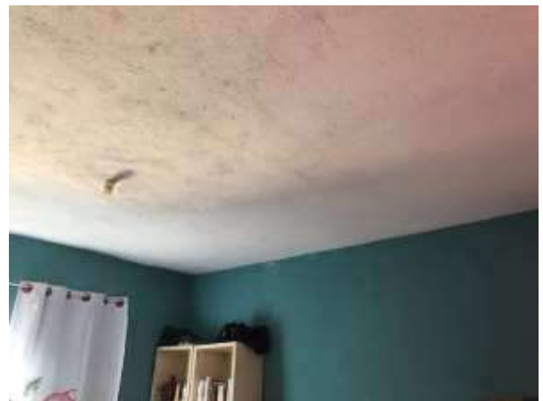
Imagem 179: Laje do dormitório 01, que deverá ter todo o seu revestimento removido.
