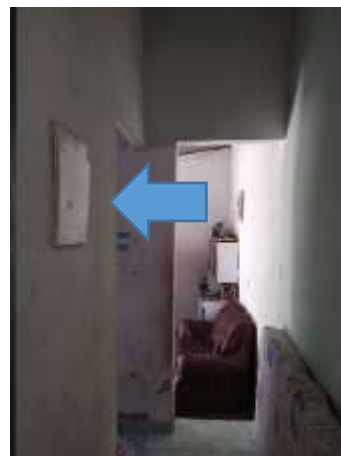
Imagem 59: Quadro de distribuição de energia existente na 2ª residência.
