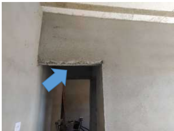
Imagem 42: Laje (não visível na foto) da circulação interna da 1ª residência que receberá gesso.
