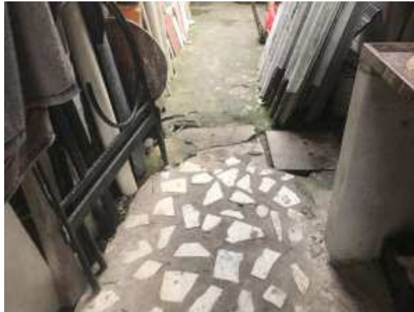
Imagem 193: Piso da área de serviço que deverá receber piso cerâmico, após ter sido demolido.
