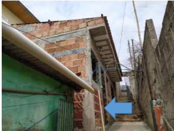
Imagem 54: Tubulação de esgoto já existente na parede externa da cozinha da 1ª residência.
