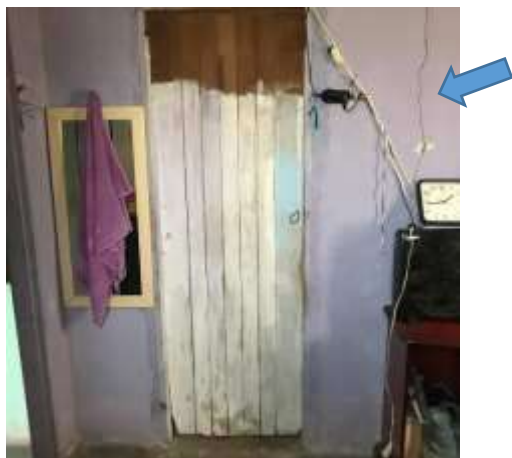
Imagem 284: Porta (folha e batente) a ser removido. Atentar-se a fragilidade da parede, conforme trinca evidenciada.
