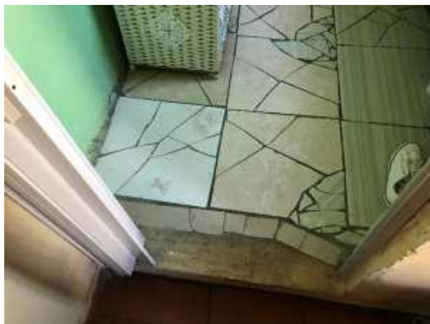
Imagem 116: Indicação do piso do Quarto 3 para substituição.
