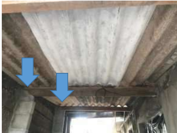
Imagem 186: Pilares que sustentam o telhado da área de serviço que deverão ter sua altura aumentada com o uso de blocos de concreto estrutural, preenchidos com concreto e armadura.
