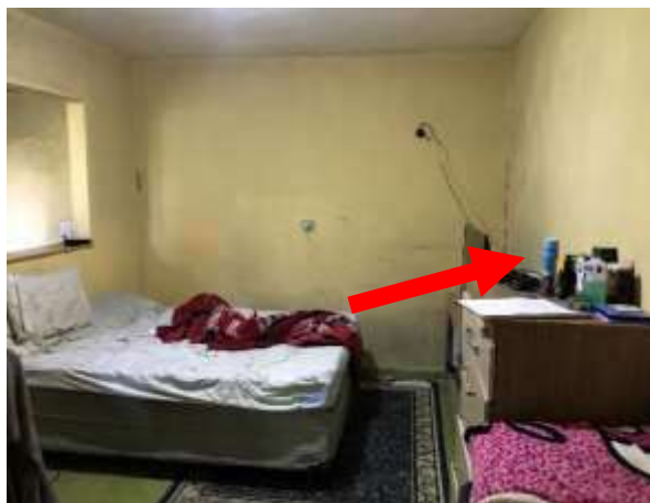
Imagem 130: Visão do Quarto 3 com previsão de reparo na argamassa de revestimento.
