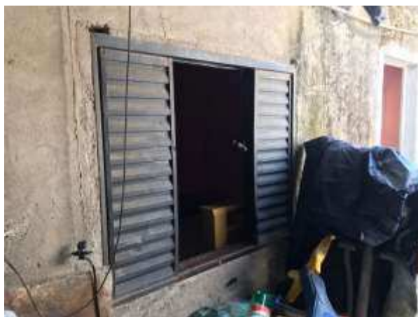
Imagem 182: Janela do dormitório 02 a ser removida.
