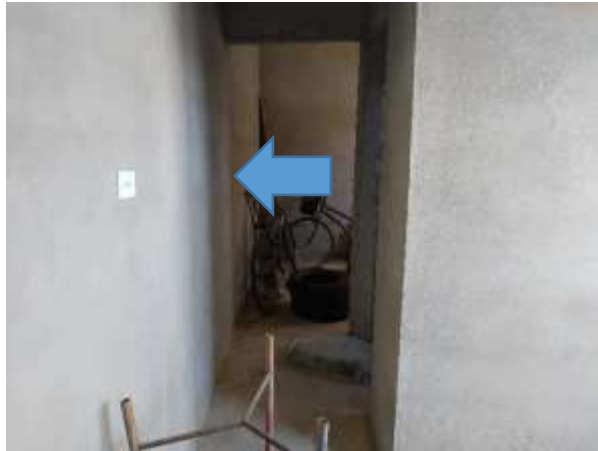
Imagem 26: Vista da parede do corredor interno da 1ª residência onde deverá ser instalado o novo quadro de distribuição de energia.
