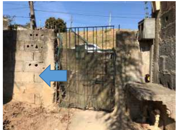
Imagem 18: Posição de instalação do novo poste de energia (vista de dentro do lote).
