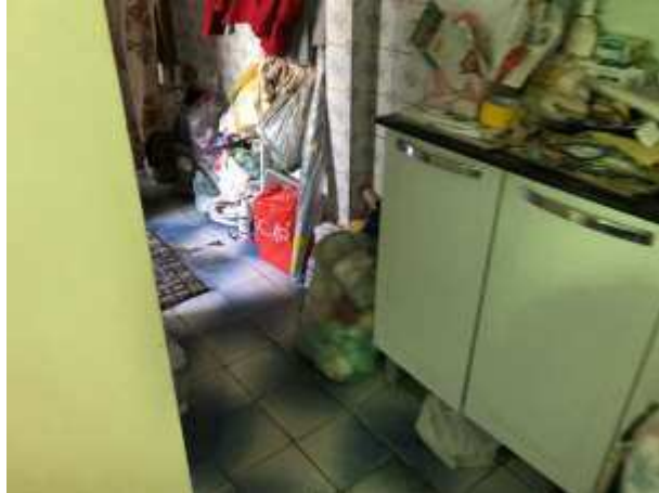
Imagem 138: Indicação do piso da cozinha para substituição.
