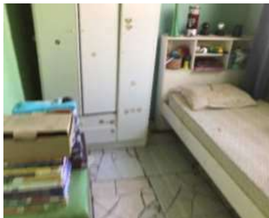
Imagem 117: Indicação do piso da Quarto 3 para substituição.
