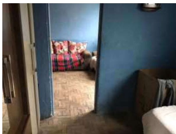
Imagem 273: Dormitório. Taco a ser removido
