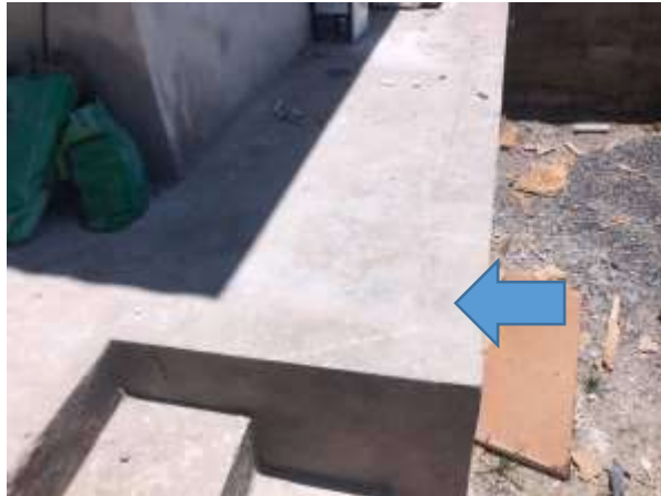
Imagem 187: Posição onde deverá ser instalada a grelha para a captação das águas pluviais vindas do corredor externo lateral à residência.
