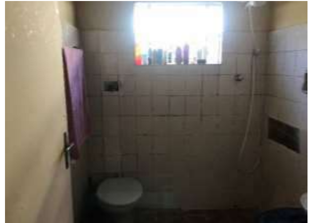
Imagem 121: Indicação do banheiro 1, onde serão substituídos os aparelhos sanitários.
