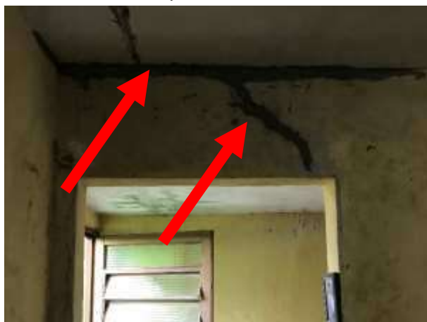
Imagem 133: Indicação de uma das trincas a ser reparada no Quarto 3.
