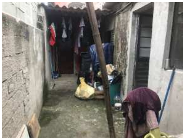
Imagem 194: Piso do corredor externo lateral à residência, onde será executado piso de concreto armado após a demolição do piso existente.
