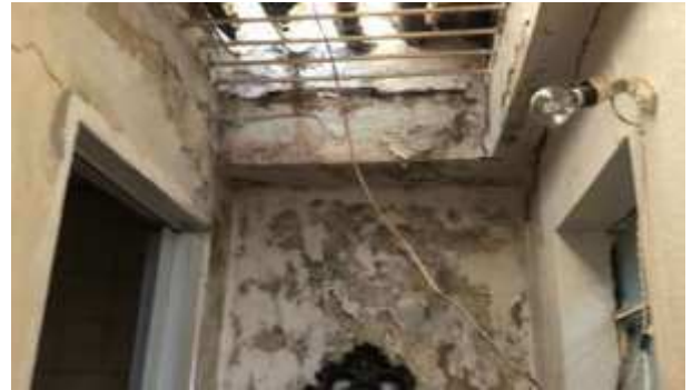
Imagem 156: Demolir a argamassa das 03 (três) paredes do corredor em frente ao banheiro 01.
