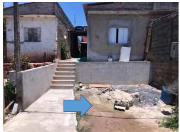
Imagem 195: Piso no recuo frontal do imóvel, que receberá piso de concreto armado.
