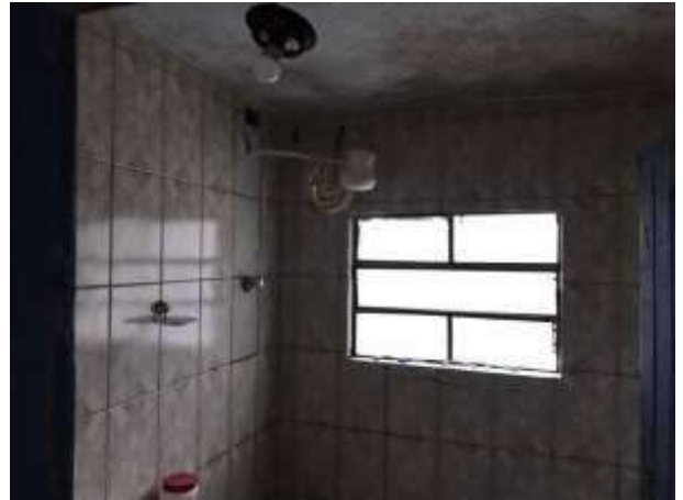
Imagem 277: Banheiro. Plafonier ser removido.
