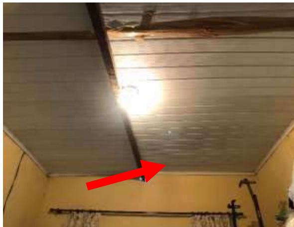
Imagem 97: Visão do Quarto 1 com indicativo do forro de PVC que deverá ser substituído.
