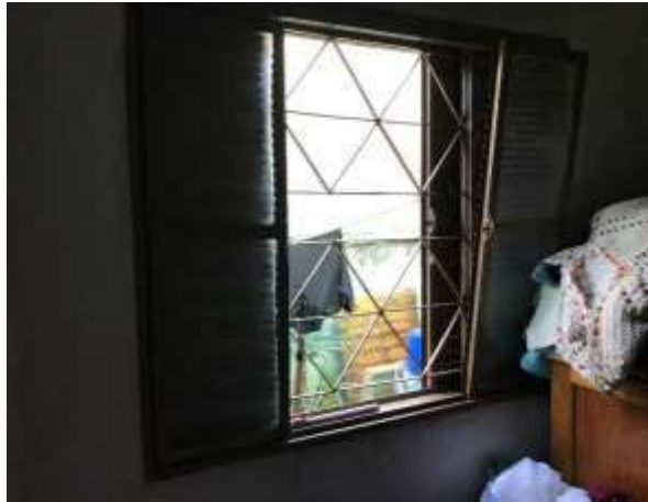
Imagem 126: Vista da Janela J6 no Quarto 2 para substituição.
