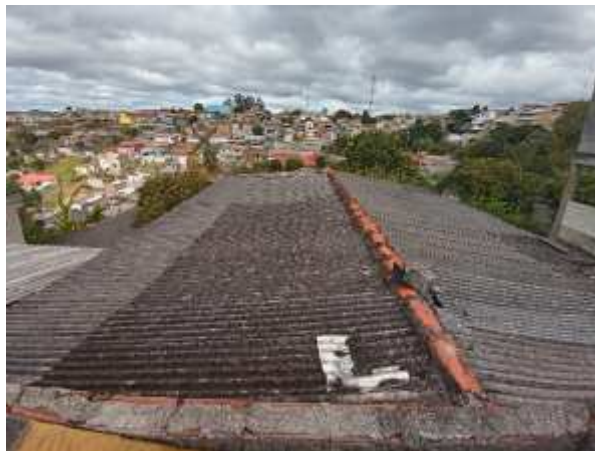
Imagem 234: Telhado e alvenaria de cobertura a ser removido/demolido. Esta área contempla dormitórios, sala, banheiro e cozinha.
