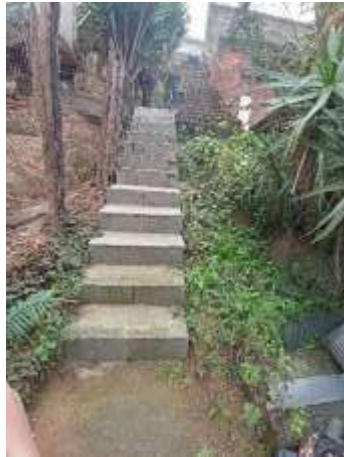
Imagem 244: Instalar corrimão à direita da escada.
