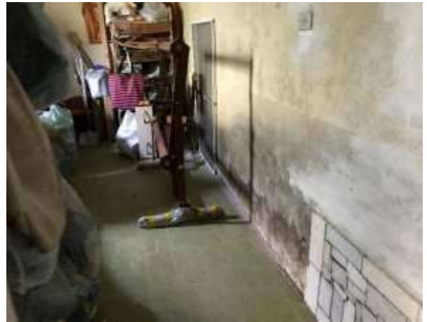
Imagem 129: Visão do Quarto 2 com previsão de reparo na argamassa de revestimento.
