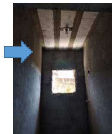
Imagem 39: Parte superior das paredes do banheiro da 1ª residência que receberão emboço interno desempenado para pintura.
