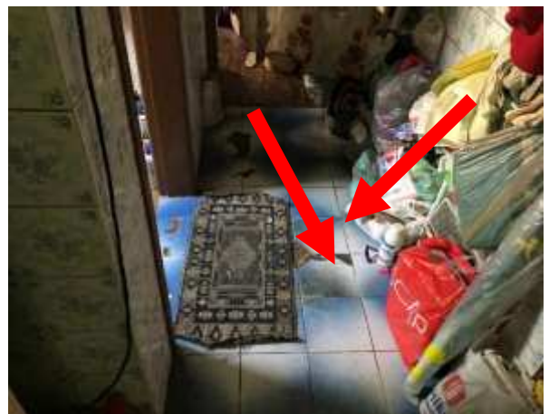
Imagem 131: Indicação do piso da cozinha para substituição.
