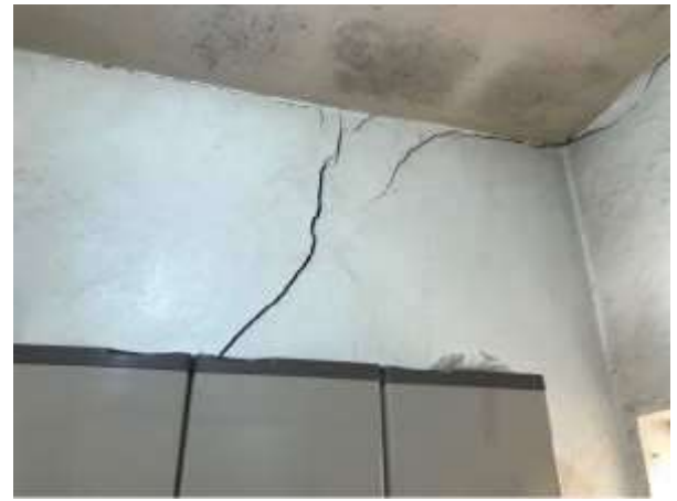
Imagem 169: Exemplo de trincas e rachaduras na cozinha.
