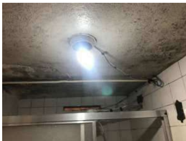
Imagem 154: Deverá ser removido todo o revestimento de azulejo existente no banheiro 01.
