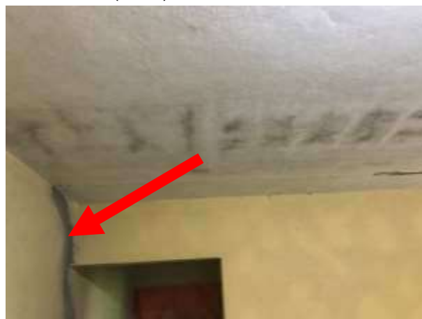
Imagem 134: Indicação de uma das trincas a ser reparada no Quarto 3.
