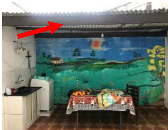
Imagem 301: Indicação do telhado na Área de Serviço que será refeito
