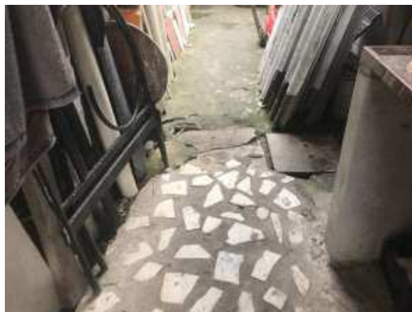
Imagem 184: Piso da área de serviço que deverá ser todo demolido.
