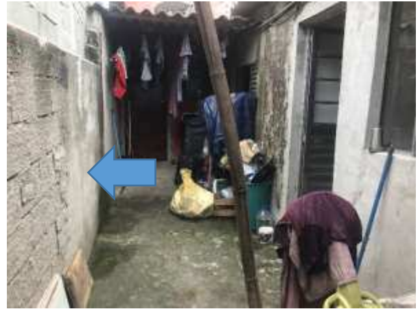
Imagem 199: Muro de divisa com o vizinho do lado esquerdo de quem da rua olha para a residência a receber pintura acrílica
