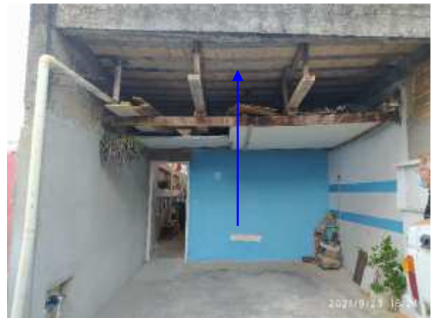
Imagem 317: Rebocar o teto e as demais frações de parede da garagem que não possuem esse tipo de acabamento.
