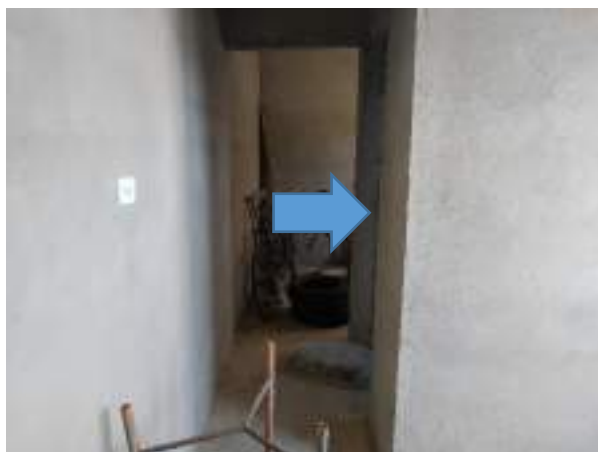
Imagem 31: Vão da porta do banheiro da 1ª residência.
