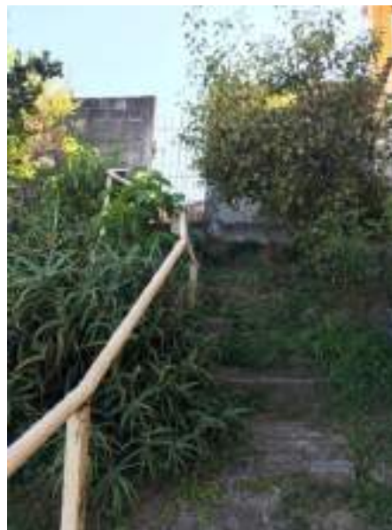
Imagem 74: Remover o corrimão existente desde o início, junto ao portão do imóvel até o término da rampa (piso de concreto).
