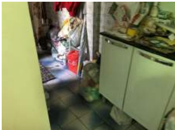
Imagem 138: Indicação do piso da cozinha para substituição.
