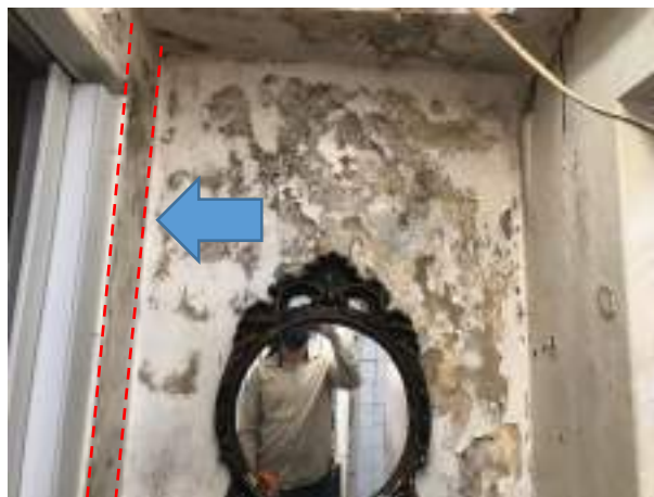
Imagem 148: Parte da parede do banheiro 01 que será demolida para a ampliação do referido ambiente.
