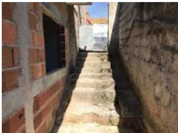
Imagem 50: Vista da escada atual, que será aterrada para a execução da nova escada de acesso às residências.
