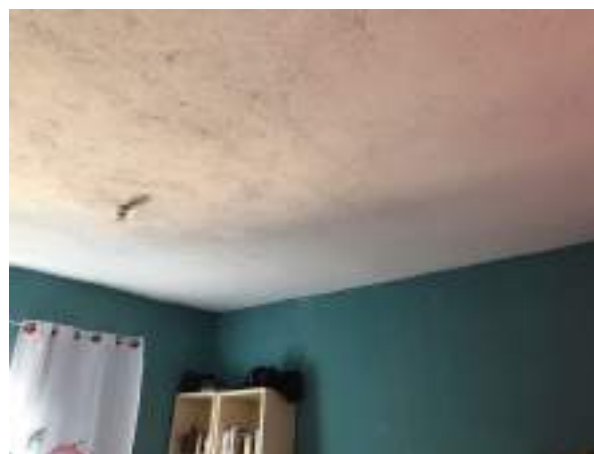
Imagem 179: Laje do dormitório 01, que deverá ter todo o seu revestimento removido.
