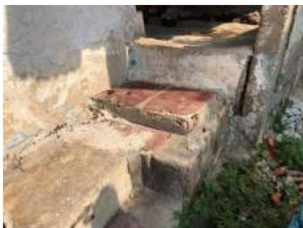
Imagem 280: Degraus a serem removidos e regularizados.
