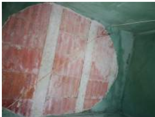
Imagem 237: Remover o reboco, de maneira completa, do teto da área de circulação.
