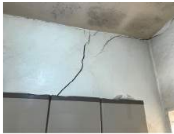
Imagem 169: Exemplo de trincas e rachaduras na cozinha.
