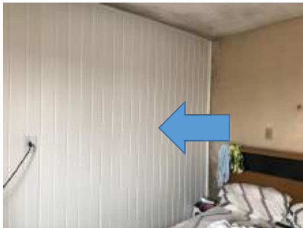
Imagem 67: Remover o forro de PVC e o reboco, de maneira completa, desta parede.
