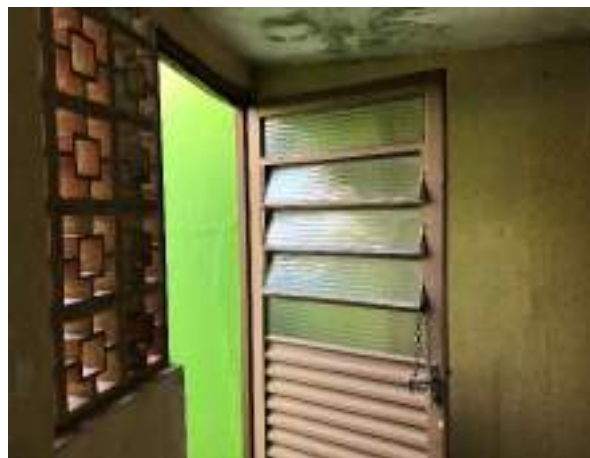
Imagem 127: Vista da Porta P5 no Quarto 3 para substituição.
