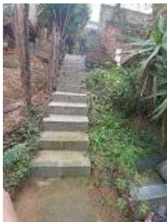
Imagem 244: Instalar corrimão à direita da escada.
