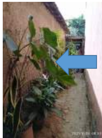
Imagem 261: Fachada lateral (esquerda) a ser rebocada.
