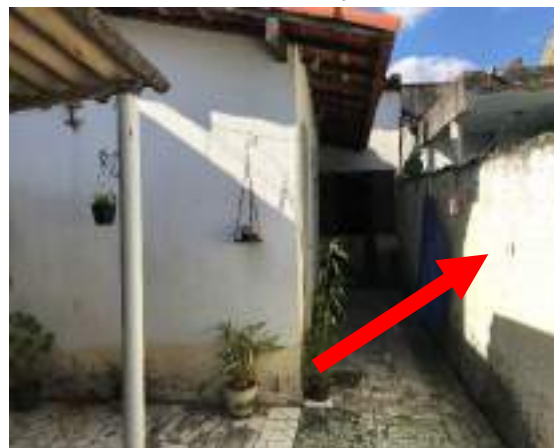
Imagem 123: Indicação do muro lateral que receberá os trabalhos de chapisco, emboço e pintura.
