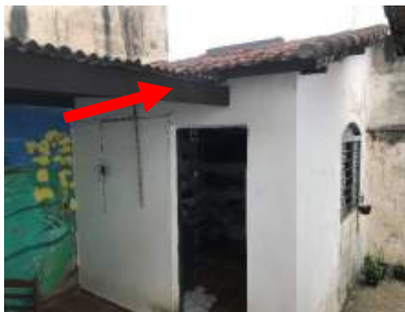
Imagem 300: Indicação do telhado na Área de Serviço que será refeito.
