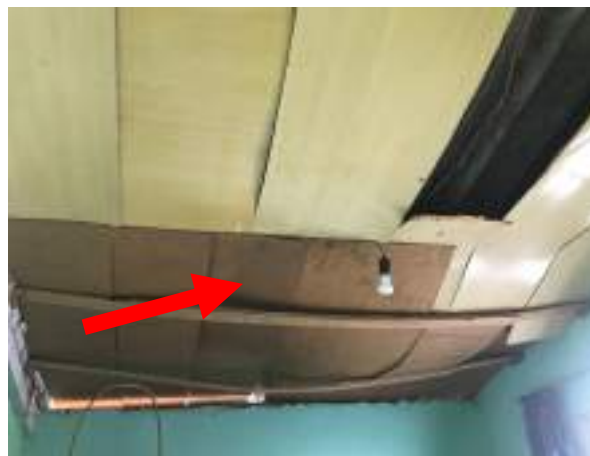
Imagem 98: Visão do forro do Quarto 3 que deverá ser substituído por forro de PVC após o aumento do referido ambiente.
