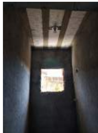
Imagem 25: Vista da janela da 1ª residência que terá seu vão aumentado de 0,60x0,60m para 0,80x 0,80m para a instalação da janela.
