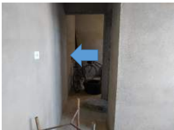
Imagem 60: Posição de instalação do novo quadro de distribuição de energia na 1ª residência.
