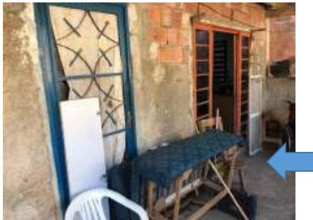
Imagem 15: Varanda: seta indicando a localização onde deverá ser construída a rampa de concreto.
