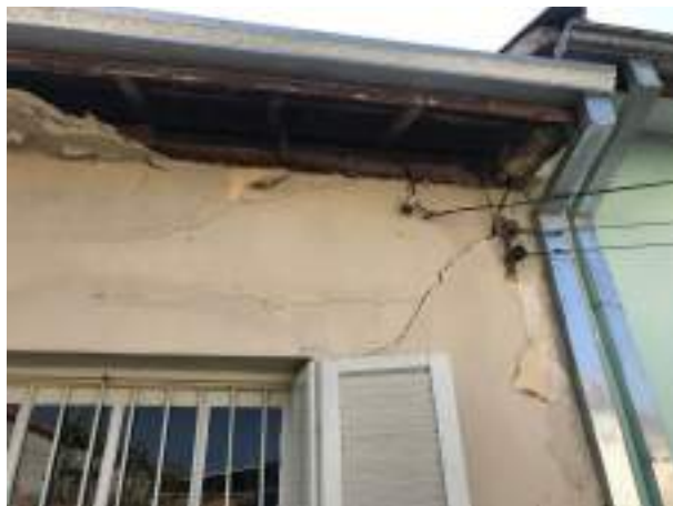
Imagem 168: Exemplo de trincas e rachaduras na fachada frontal da residência.
