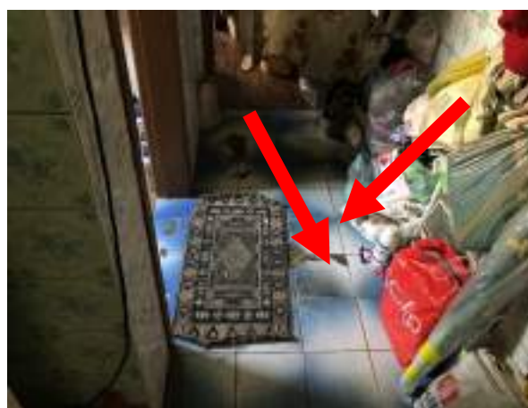
Imagem 131: Indicação do piso da cozinha para substituição.
