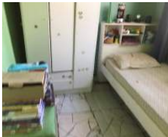
Imagem 117: Indicação do piso da Quarto 3 para substituição.
