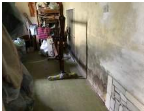
Imagem 129: Visão do Quarto 2 com previsão de reparo na argamassa de revestimento.
