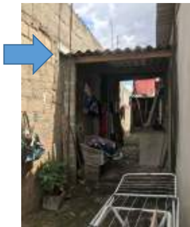
Imagem 185: Telhas de fibrocimento da área de serviço que deverão ser removidas.
