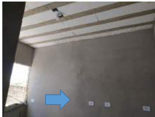
Imagem 53: Parede da cozinha da 1ª residência onde será instalado o tampo da cuba.
