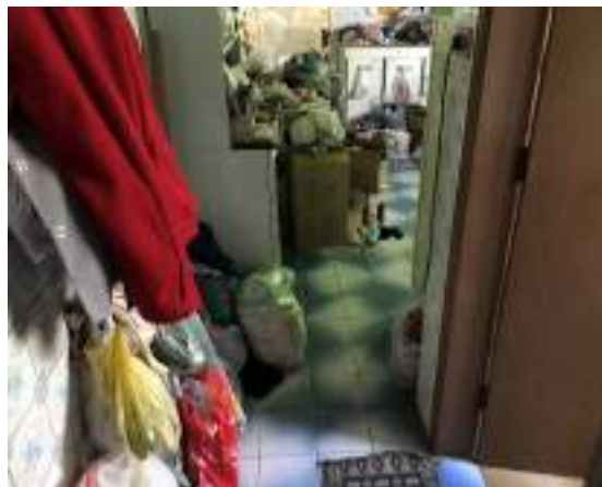
Imagem 139: Indicação do piso da cozinha para substituição.
