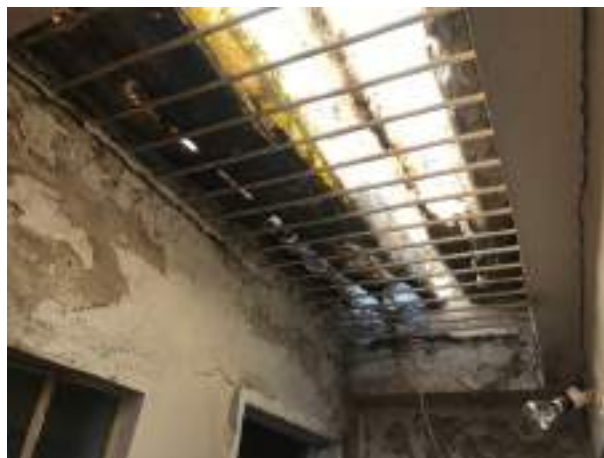
Imagem 173: Executar nova cobertura, com instalação de rufo, no corredor em frente ao banheiro 01.
