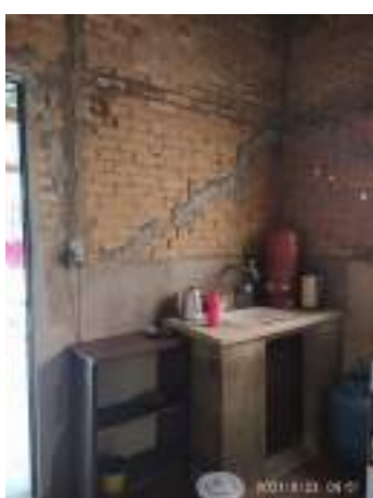
Imagem 270: Cozinha – paredes em L, que receberão revestimento cerâmico de forma parcial e pintura de acabamento.
