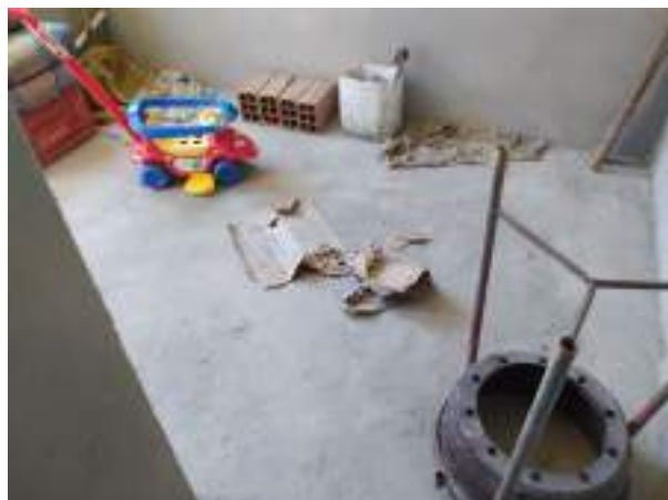
Imagem 46: Piso da cozinha da 1ª residência que receberá piso cerâmico (marca Unigress, 0,54x0,54m) e rodapé.
