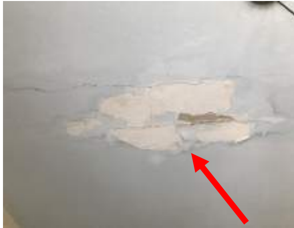
Imagem 302: Pintura descolando e trinca identificadas no teto da sala que será reparada.
