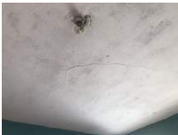
Imagem 178: Laje da sala, que deverá ter todo o seu revestimento removido. Assim como a laje em frente ao banheiro.
