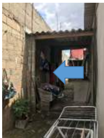
Imagem 190: Muro da área de serviço na divisa com o vizinho a receber chapisco e emboço.
