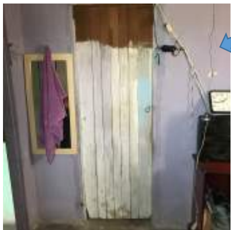
Imagem 284: Porta (folha e batente) a ser removido. Atentar-se a fragilidade da parede, conforme trinca evidenciada.
