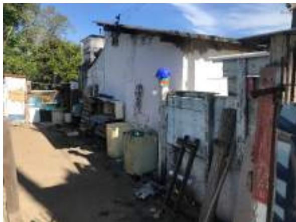
Imagem 232: Uma das faces externas que receberão pintura.
