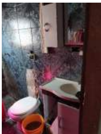
Imagem 9: Aparelhos sanitários a serem retirados, assim como a demolição da argamassa dessa parede que faz divisa com o dormitório 02 para a substituição da tubulação hidráulica que atende as peças sanitárias.
