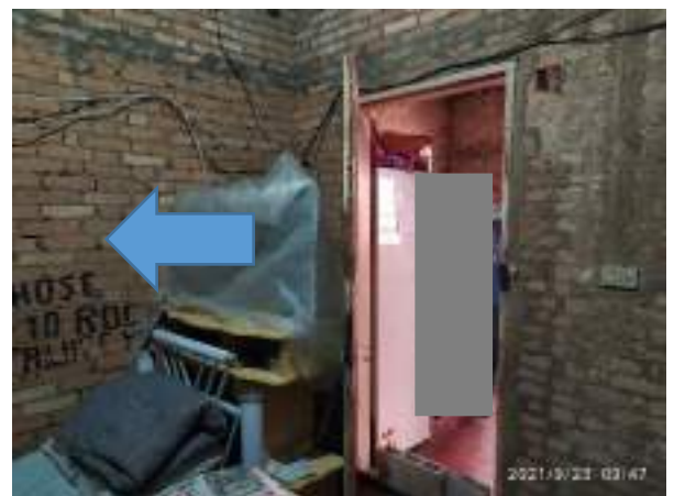
Imagem 259: Chapisco em emboço (reboco) nas paredes do dormitório 1, até altura do telhado.
