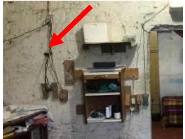
Imagem 210: Detalhes para fiação exposta que ocorre em todo imóvel.
