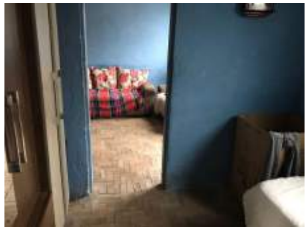
Imagem 273: Dormitório. Taco a ser removido
