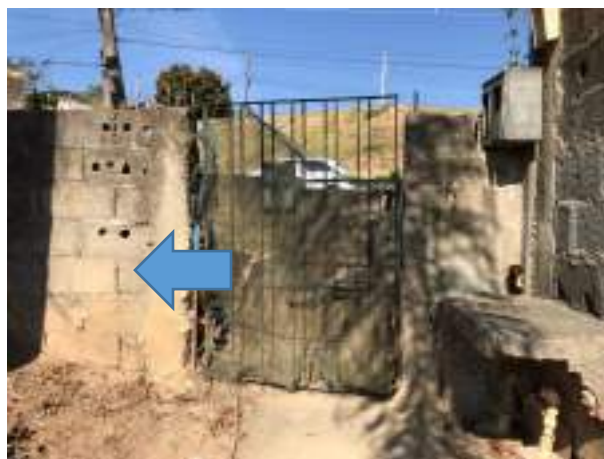
Imagem 18: Posição de instalação do novo poste de energia (vista de dentro do lote).
