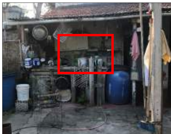
Imagem 222: Visão externa com indicação do local previsto para janela (sem escala).
