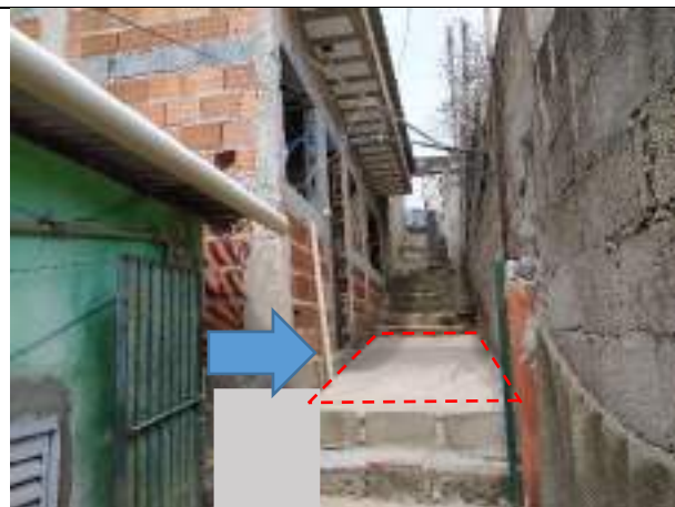
Imagem 55: Piso do corredor externo onde serão instaladas a primeira caixa de inspeção e uma caixa de gordura.
