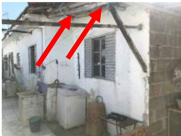
Imagem 108: Indicação do telhado sobre Quarto 3 e Área de Serviço que será refeito.
