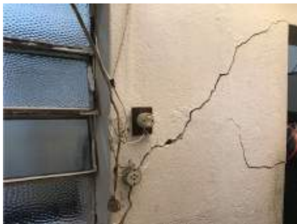
Imagem 170: Trincas e rachaduras no corredor em frente ao banheiro 01.
