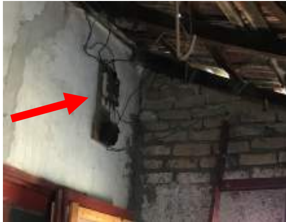
Imagem 209: Visão do quadro de distribuição.
